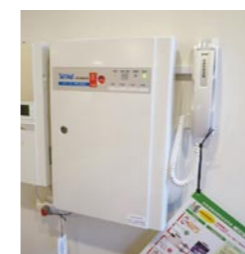
テルウェル東日本が運営する「ほごころ保育園」にも非常通報装置が設置されている
